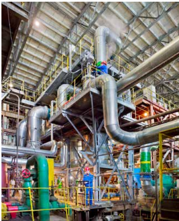
Новая установка подогрева сетевой воды для теплоснабжения г. Рязани
