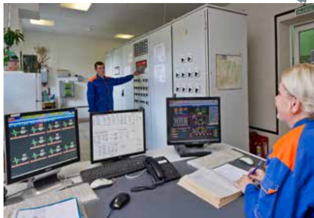
Щит управления новым мазутным хозяйством
