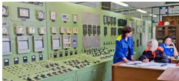
Щит начальника смены химцеха (ХВО-1)
