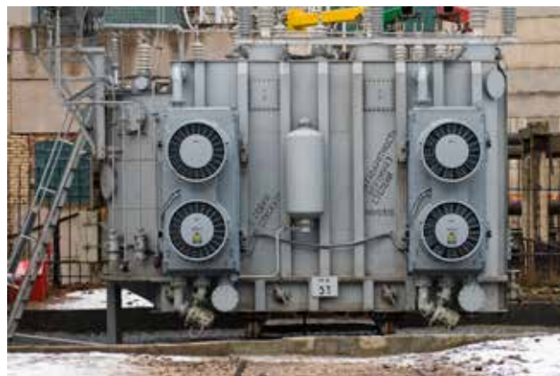
Новый силовой трансформатор №5Т
