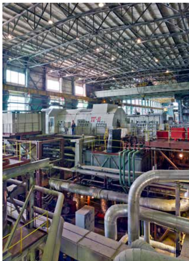
Турбинный цех. Теплофикационная турбина №6
