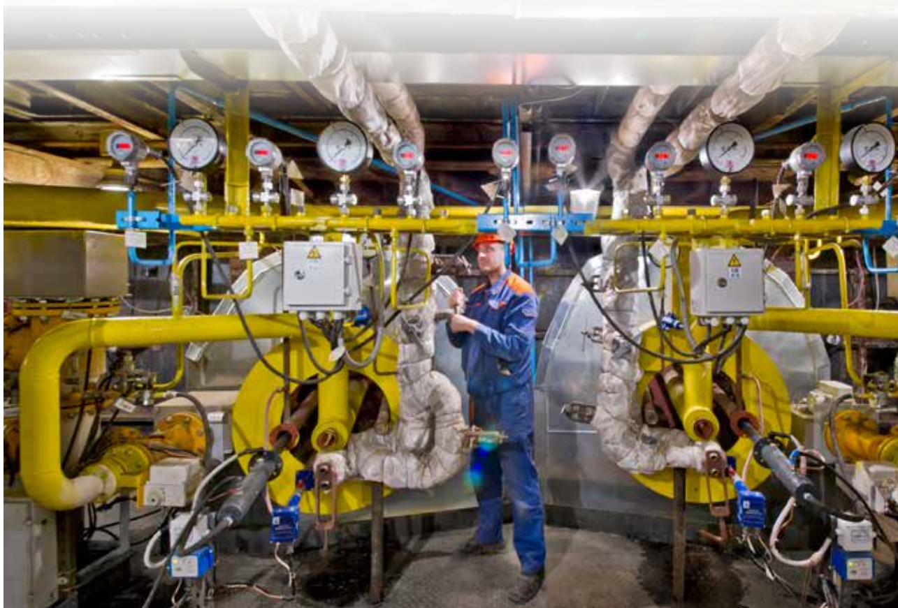
Новые двухпоточные газовые горелки на котлоагрегате № 6 после реконструкции его газового хозяйства
