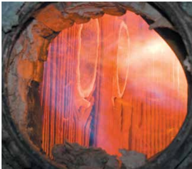
Топка котлоагрегата. Здесь рождается тепло
