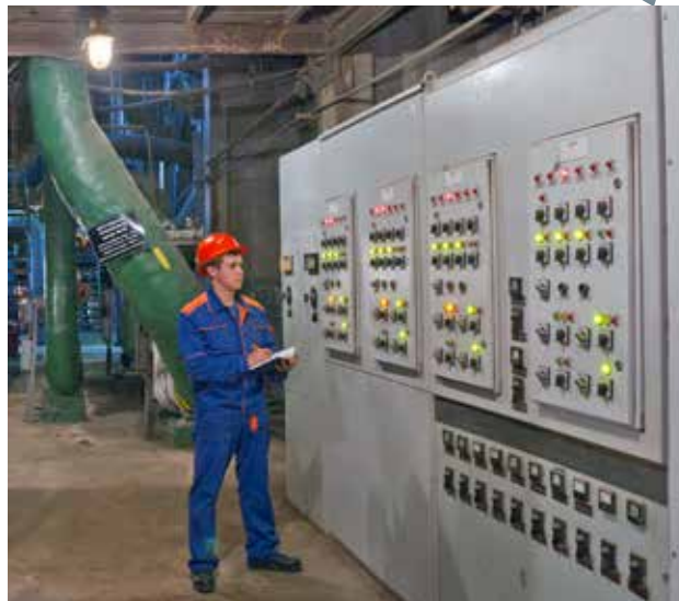
Местный щит управления котлоагрегатом №10
