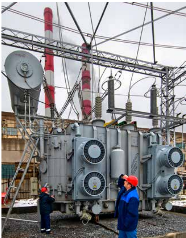
Силовой трансформатор №5Т
