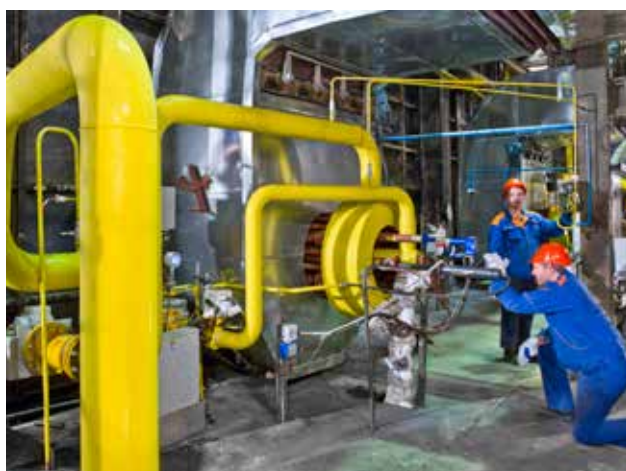
Оборудование нового газового хозяйства котлоагрегата №6
