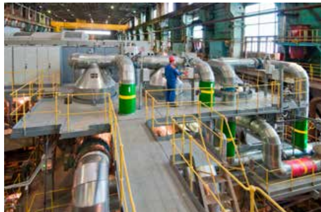
Установка подогрева сетевой воды
