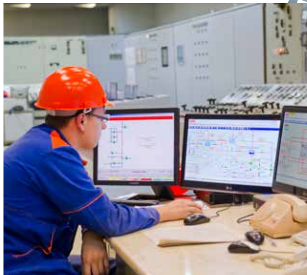
На щите управления установкой подогрева сетевой воды на город Рязань
