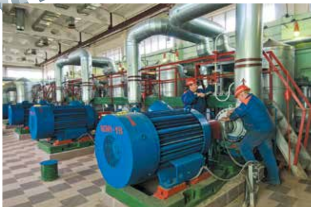
Насосные установки нового мазутного хозяйства
