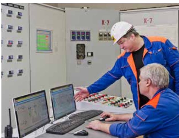
На щите управления котлоагрегатом №6
