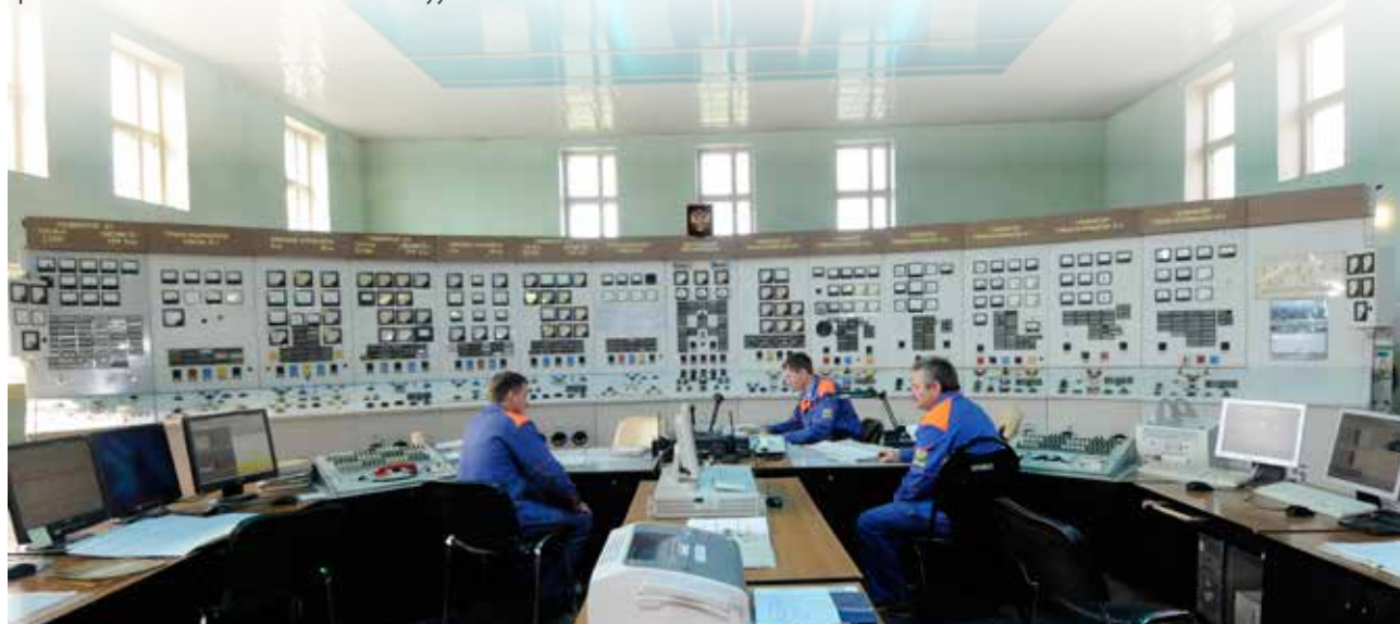
Главный щит управления ТЭЦ
