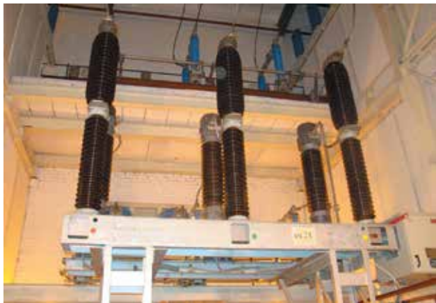
Элегазовые выключатели дополнительных ячеек ЗРУ 110 кВ
