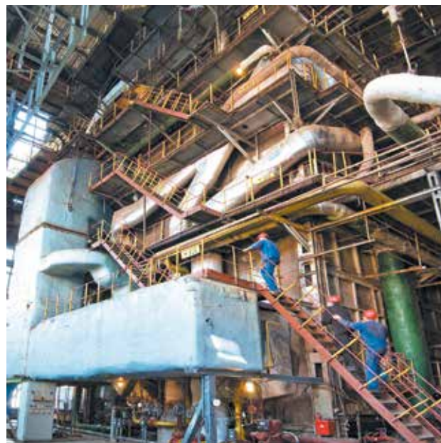
Котельный цех. Котлоагрегат №1
