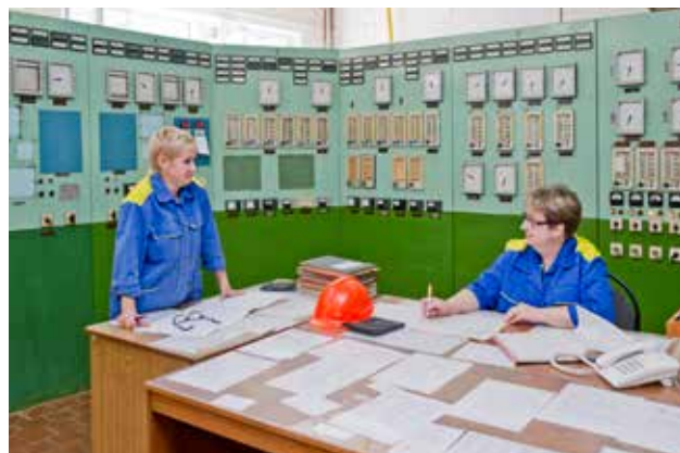
Щит управления ХВО-2
